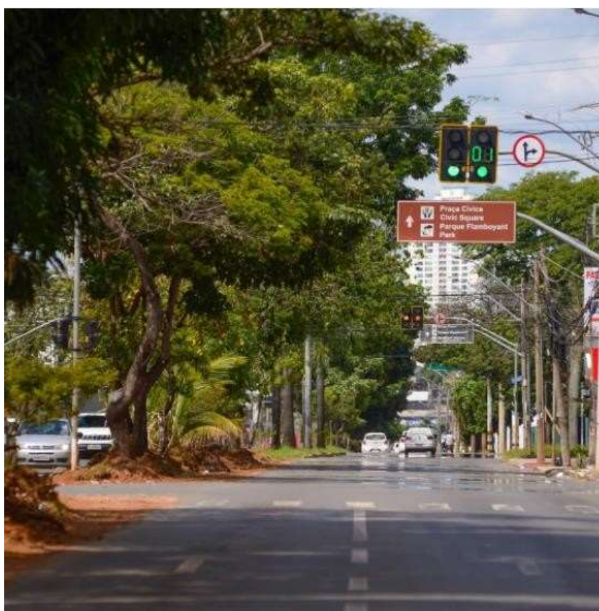
Figura 9 - Árvores da Avenida Castelo Branco comprometidas, que quebram o asfalto ou que provocam acidentes
